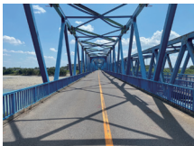
よく見るとセンターラインが歪んでいるのが分かります
