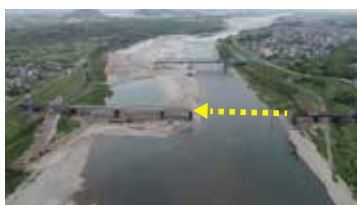
4/26 時点の状況※岐阜国道事務所HPより引用
